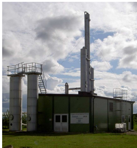
Epuration du biogaz par lavage au Selexol (Suède)
