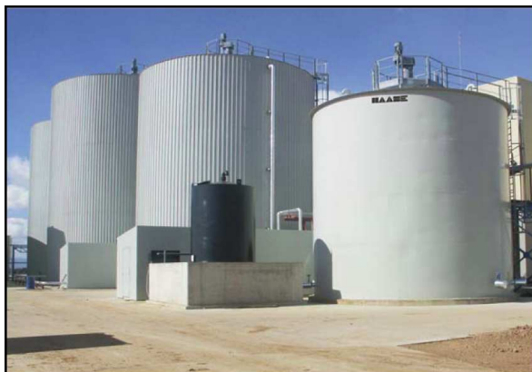
Installation de traitement mécano-biologique de Leon (Espagne) de type Haase
