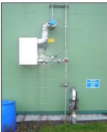
Station d'injection du biogaz dans le réseau de GN de l'installation de Laholm
