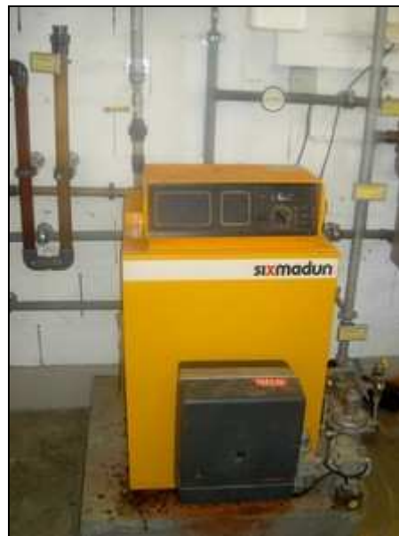
Chaudière à gaz actuelle
