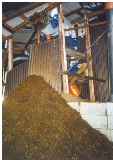
Séparateur de phases et digestat solide
